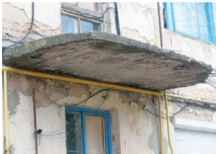
Дашки гуртожитку на ладан дихають. Приміщення не ремонтували з часів здачі в експлуатацію
